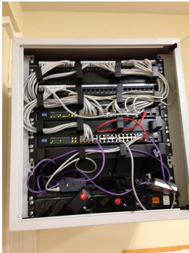
RACK 2 (1ª Planta, Edificio Primaria)
