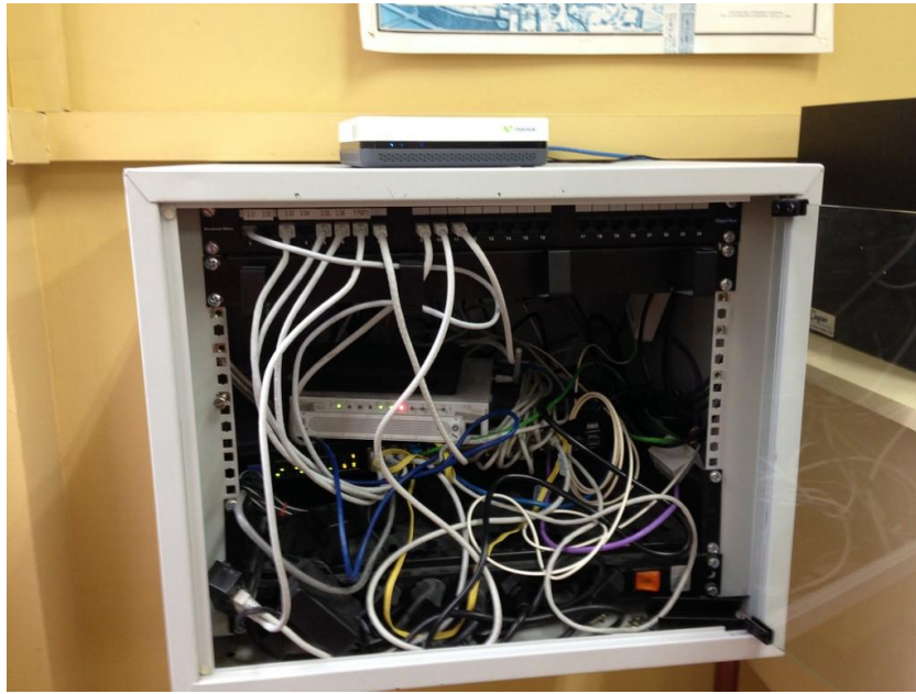
RACK 1 - PRINCIPAL (2ª Planta, Edificio Primaria)
